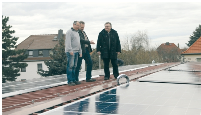
Als Bürgermeister Ludwig Martin (r.) sich am 28. Dezember auf dem Dach der Kita „Parthenflöhe“ umschaute, war die Montage der Solarmodule weitestgehend abgeschlossen.
